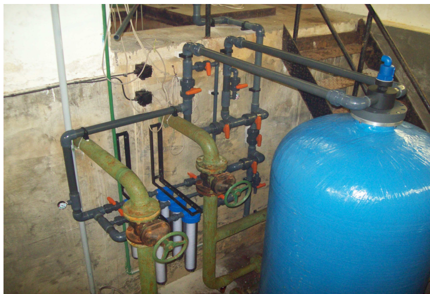
Obr. 2. Předúprava a samotný oduranovací filtr
