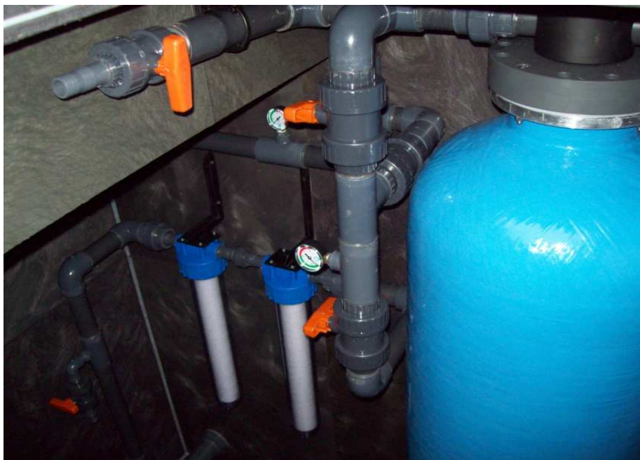
Obr. 4. Předúprava a oduranovací filtr
